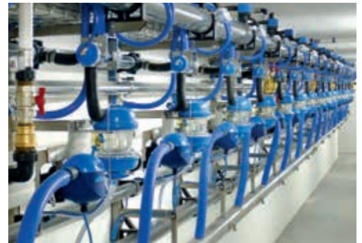
Impiantistica nel tunnel Subway installation
